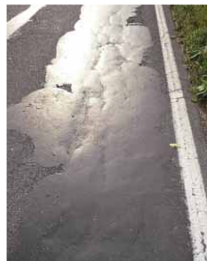
Pfusch am Bau: zu viel Bitumen, zu wenig und eingesunkener Splitt.
